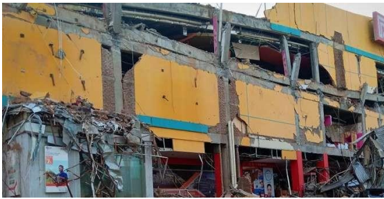
Gambar 1. Keruntuhan getas struktur bangunan bertingkat rendah (sumber : Koleksi pribadi)
